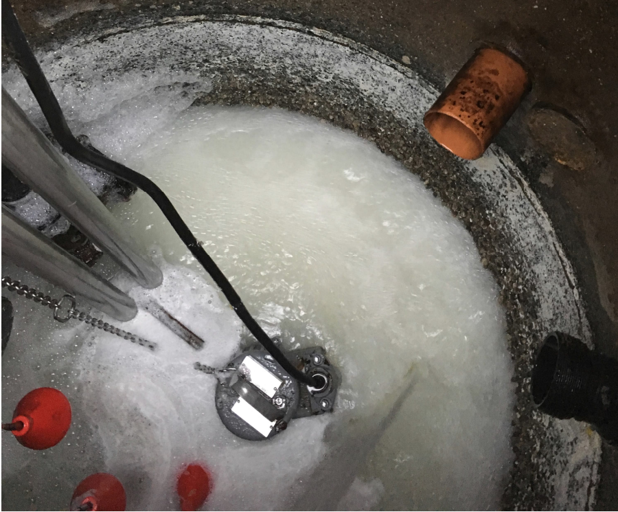
Abbildung 1 - Stapelbehälter mit Tauchpumpe. Erst durch Abpumpen des Abwassers wurden Schäden an den Schachtwänden sichtbar: Über der Wasserstandslinie besteht eine glatte Betonwand, während die Oberfläche im benetzten Bereich stark aufgeraut bzw. verfressen ist.
