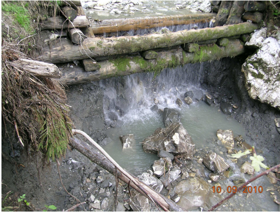
Zerstörte Holzsperrre "Chaisten"
