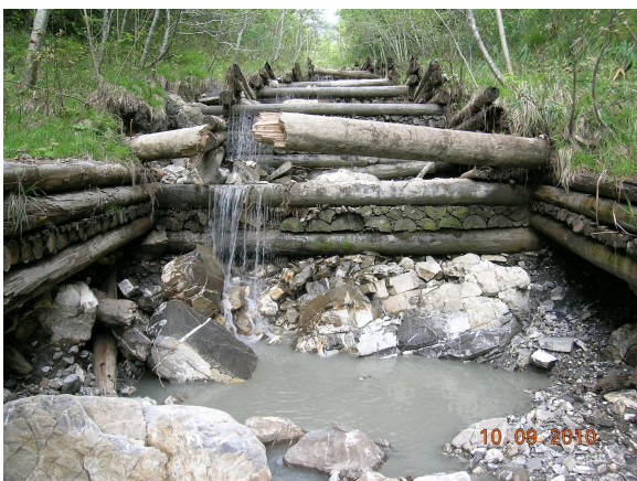
Teilweise zerstörte Holzsperrern "Gründel"
