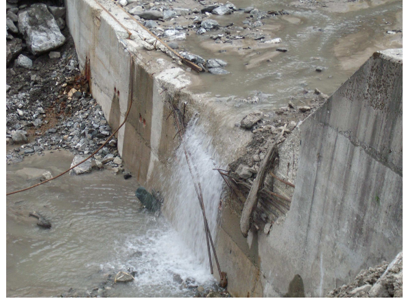
Beschädigte Sperre am Surbrunnenbach
