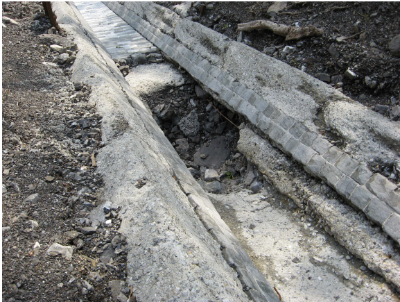
Stark beschädigte Wildbachschale
