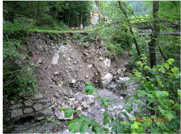
Zerstörte Ufersicherung am Klingentobelbach
