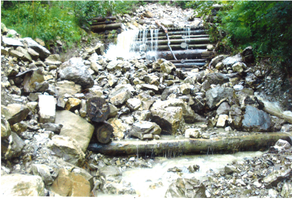
Teilweise zerstörte Holzsperrn im Oberlauf
