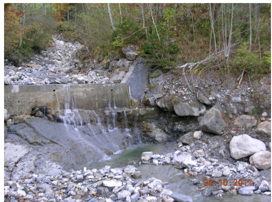
Zerstörte Ufersicherung im Geschiebesammler
