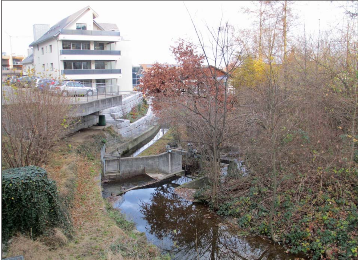
Fassung des Kraftwerks Unterwühle am Krebsbach
