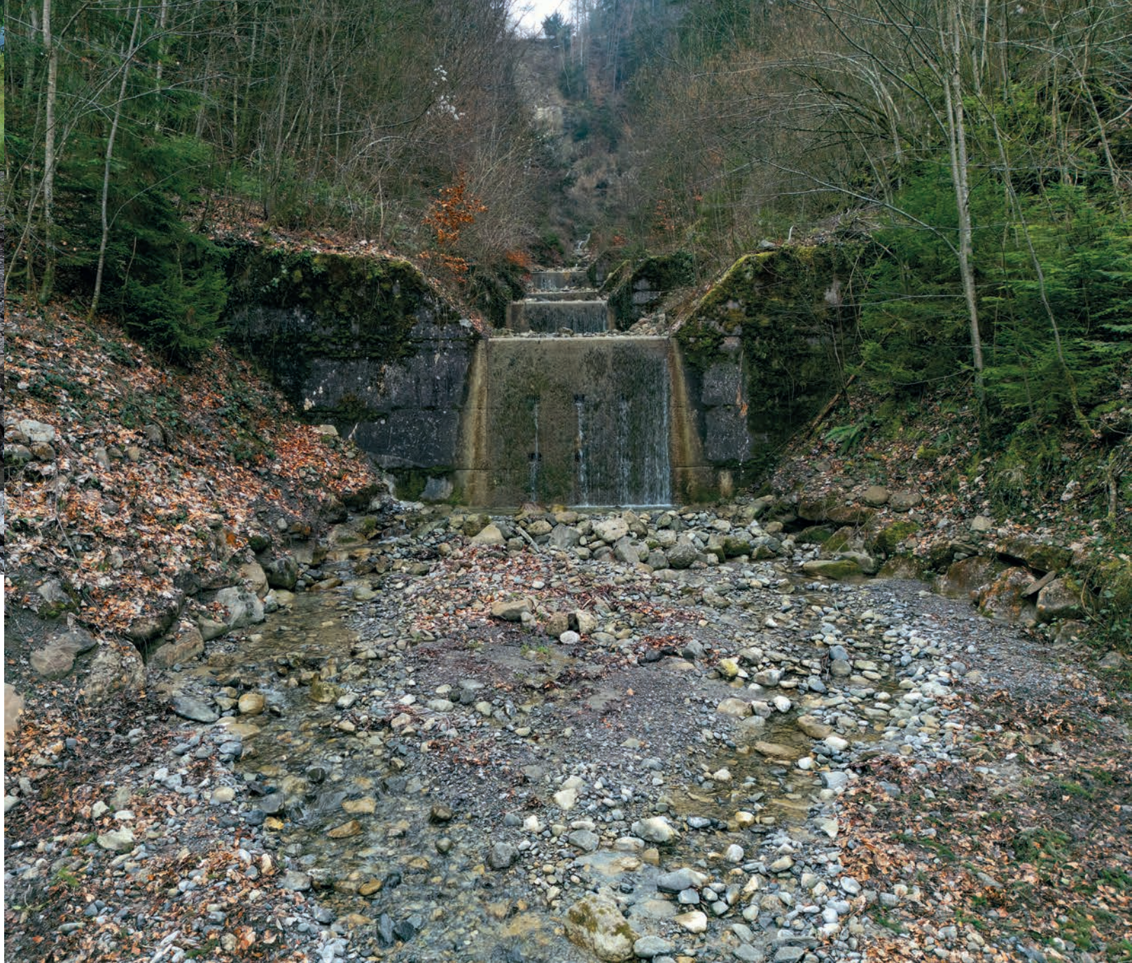
Foto 11: Geschiebetreppe mit regelmässiger Materialentnahme.
