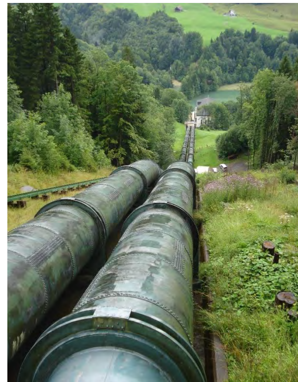
Druckleitung KW Wägital
